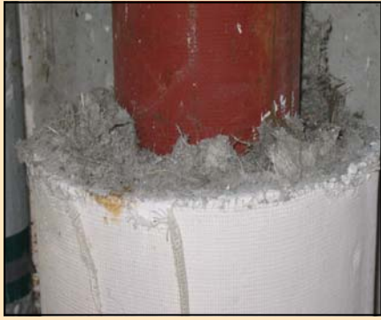
Peluches dégradées après découpe du calorifuge dans une gaine technique d'un service du CHU
